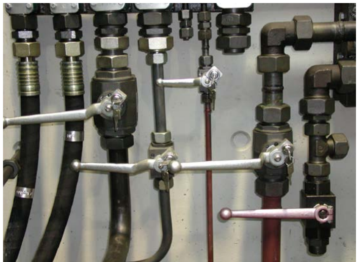
Abb. 3 Sichern gegen Wiedereinschalten durch abschließbare Kugelhähne
