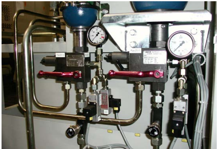
Abb. 25 Druckentlastete Hydrospeicher mit abgesperrten Druckleitungen
