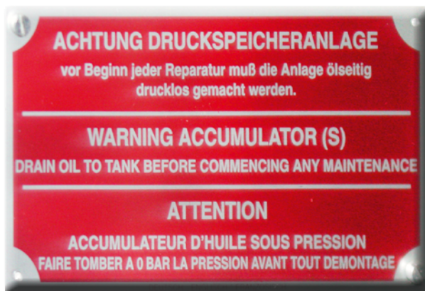
Abb. 21 Warnhinweis an Druckspeicheranlage
