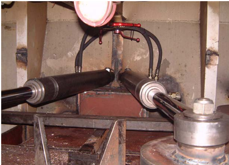
Abb. 42 Quetschgefahren an einer Ruderanlage
