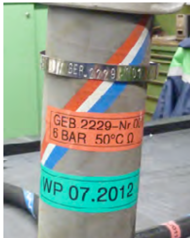
Abbildung 21: Beispiel einer gekennzeichneten Rohrleitung
